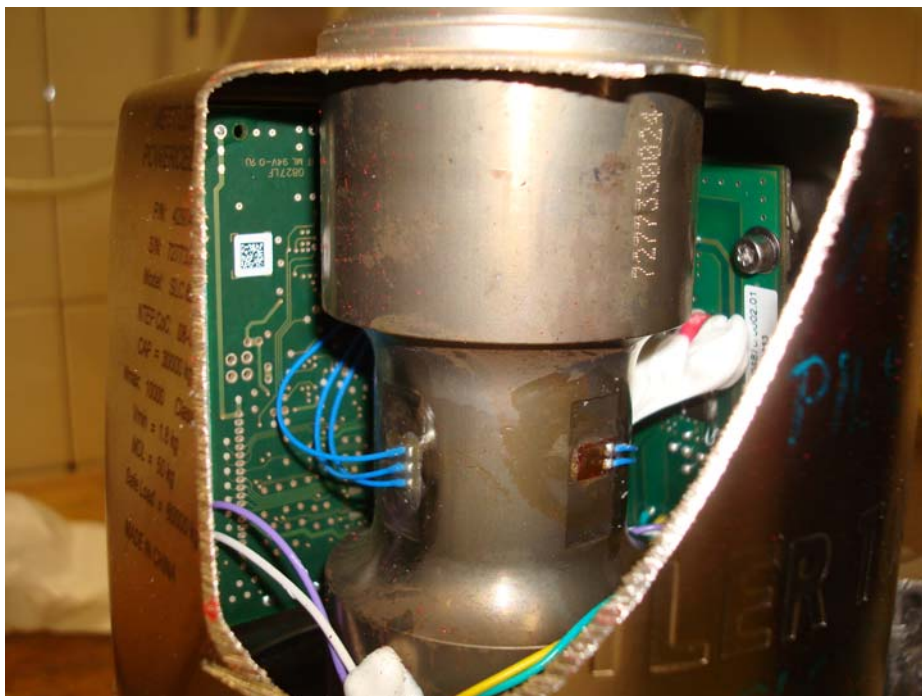
Enclosure open with cabling, no water penetrated Gehäuse offen mit Verdrahtung, kein Wasser eingedrungen
